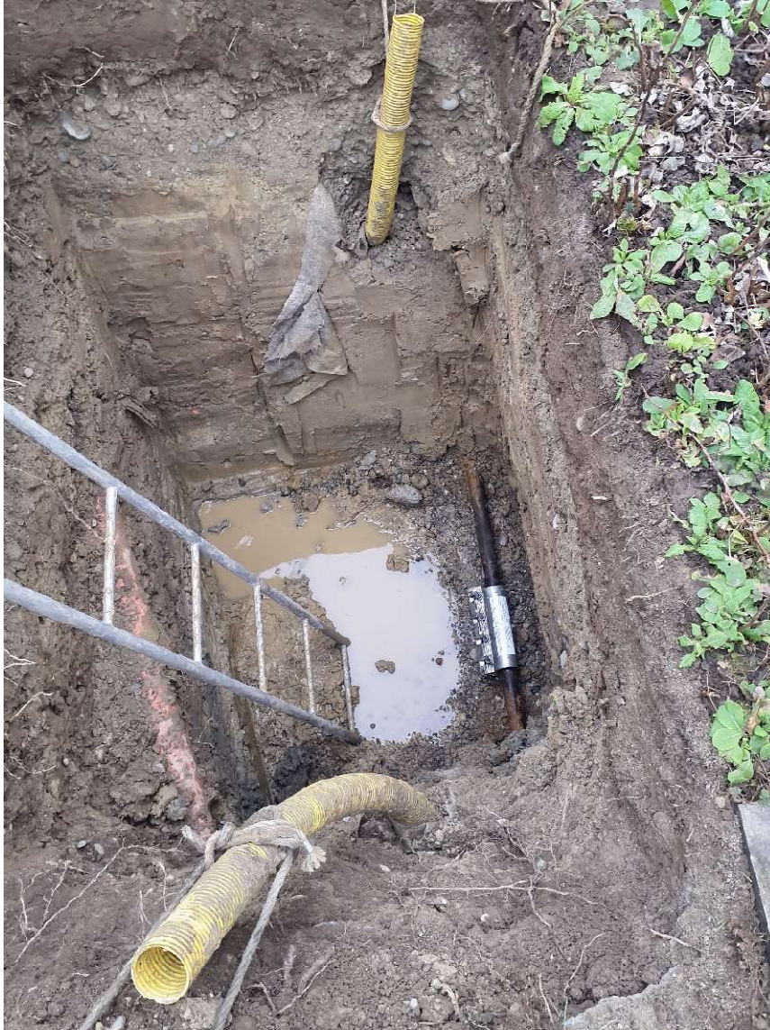
Leitungsbruch Schüepis, Schwerzenbach (Kurt Bollinger)
