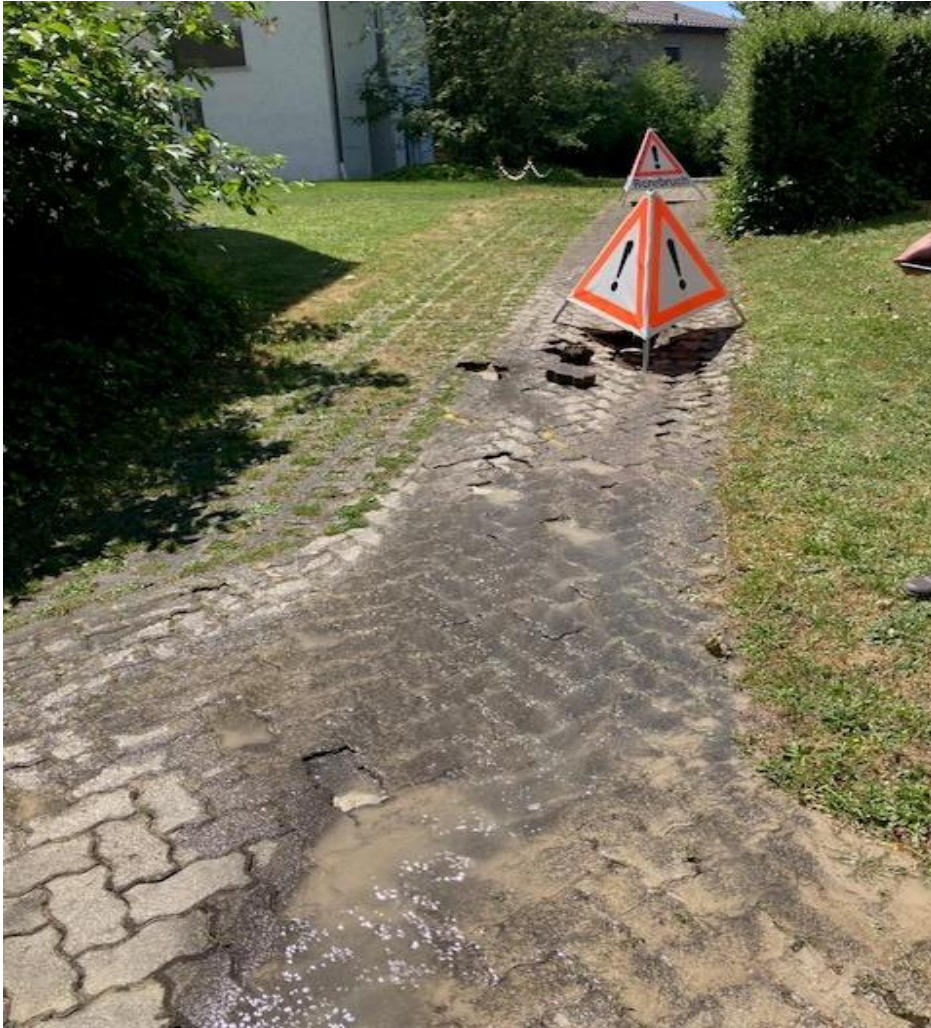
Leitungsbruch Oberholz, Schwerzenbach (Kurt Bollinger)
